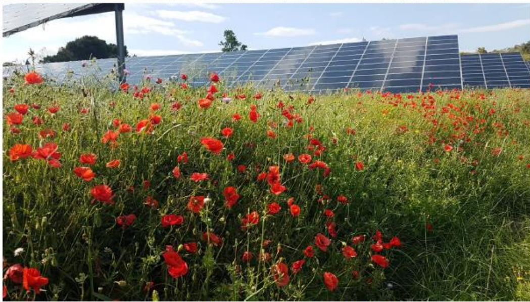
Photo 1 : centrale photovoltaïque de Narbonne (source : SA, 05/2018)
